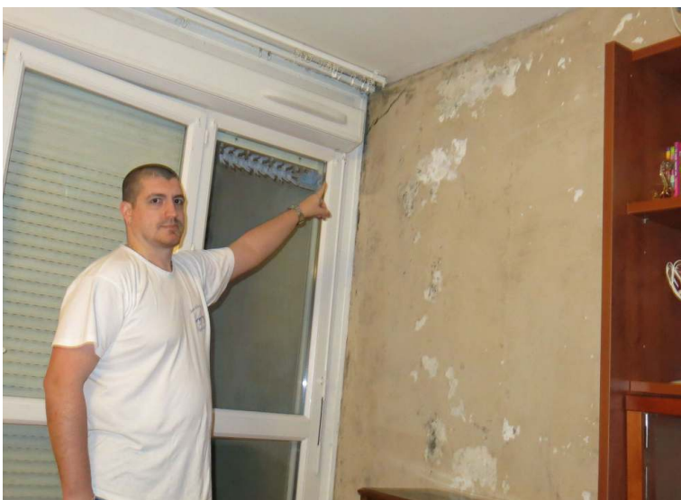
Sartrouville, mardi dernier. Papa d'un bébé de deux mois, Dimitri, locataire au 3, rue de Seine, montre les traces d'humidité qui ont envahi l'ensemble des pièces de son appartement. (LP/H.R.)
